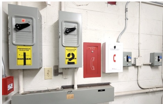
Panneaux électriques et téléphone d'ascenseur.
