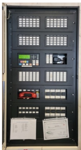
Panneau d'alarme incendie (PAI)
