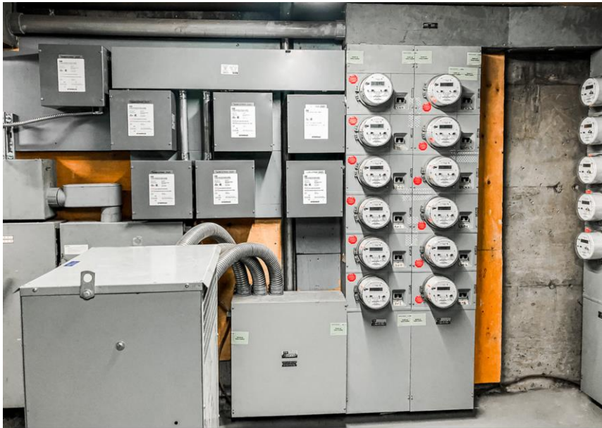
Figure 7 Exemple d'installation de DCC
