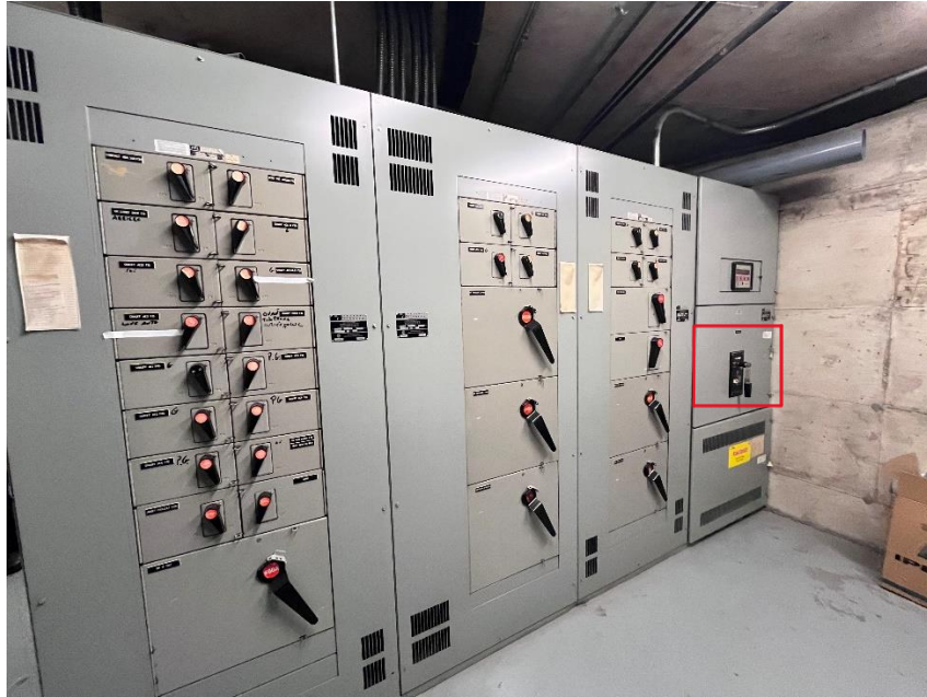
Figure 4 Interrupteur principal des services communs
