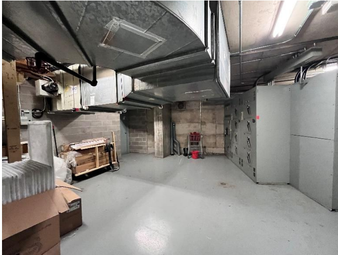
Figure 6 Extrait de l'espace dans la salle électrique principale
