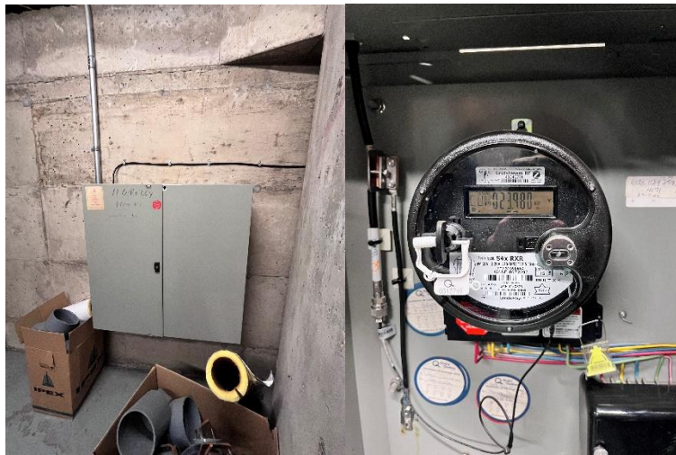
Figure 5 Armoire de mesurage d'Hydro-Québec
